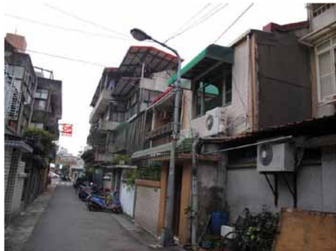
現況：建物結構不符現行法令規定
